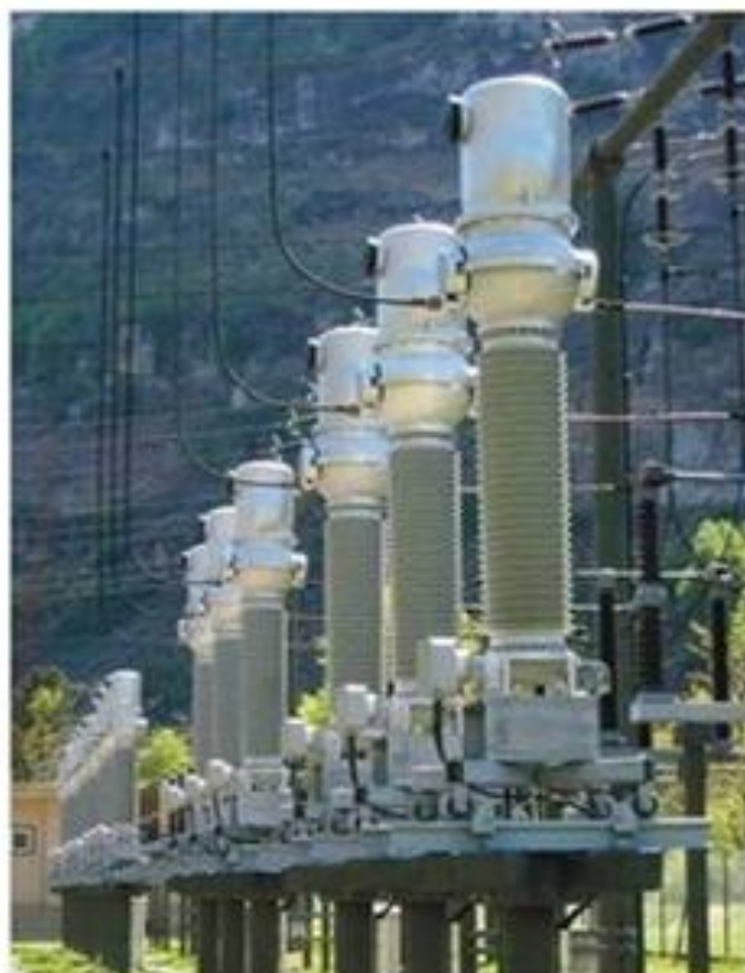
Slika 6.16: SF 6 plinom izolirani kombinirani transformator
