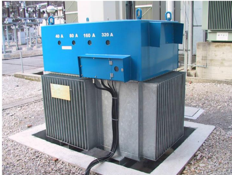
Slika 6.4. Automatska kompenzacijska prigušnica u TS 110/20 kV Crikvenica [4]
