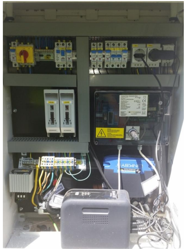
Slika 4.9. Razvodni ormar elektrane sa sklopnom, zaštitnom, regulacijskom i komunikacijskom opremom
