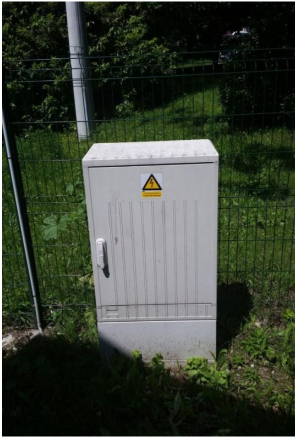
Slika 4.8. Razvodni ormar RO-FN
