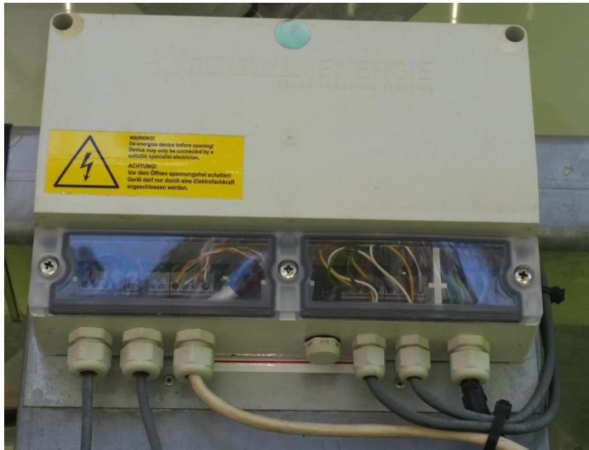
Slika 4.4. Mjesto priključenja kabela
