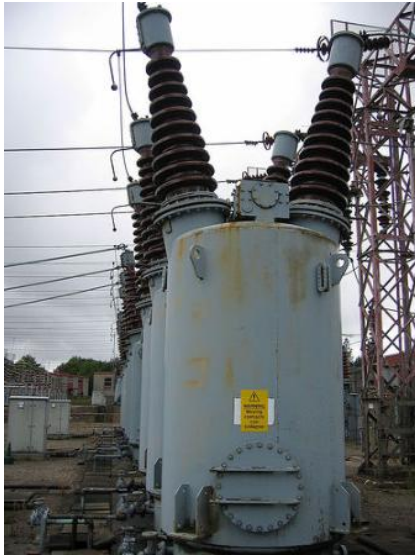
Slika 3.3. Uljni prekidač 66 kV
