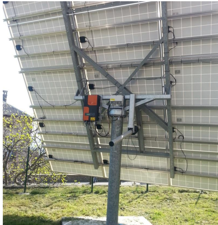
Slika 1.3. Fotonaponska elektrana Riteh-1 (Fotografirao autor)
