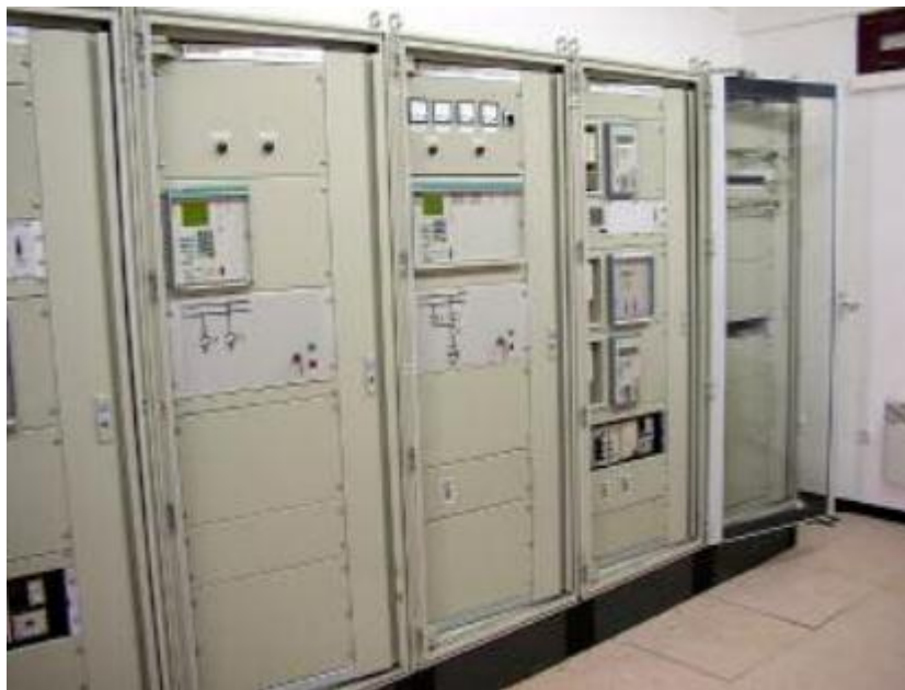
Slika 6.3. Sustav zaštite, upravljanja i mjerenja u TS Žerjavinec
