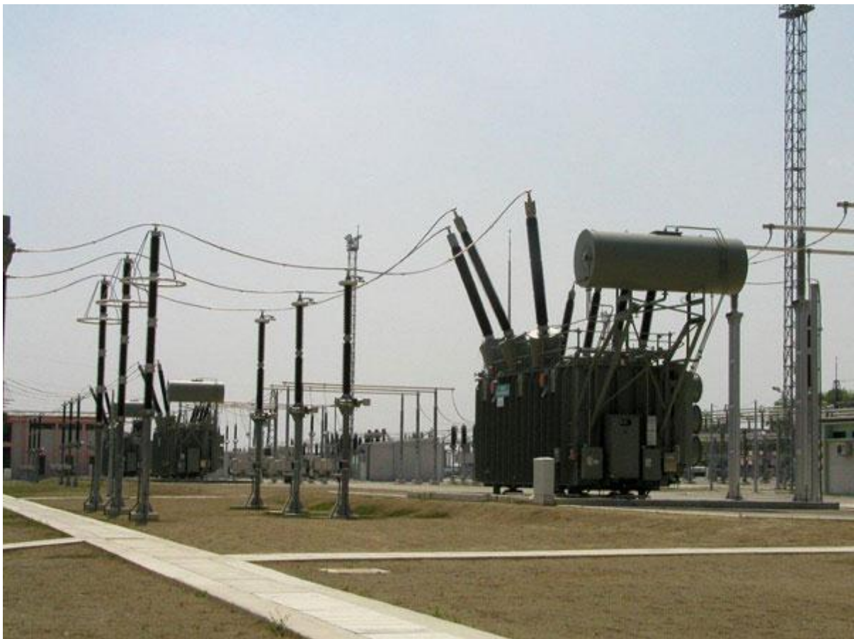
Slika 6.1. Prikaz energetskog transformatora 400/220kVu TS Žerjavinec
