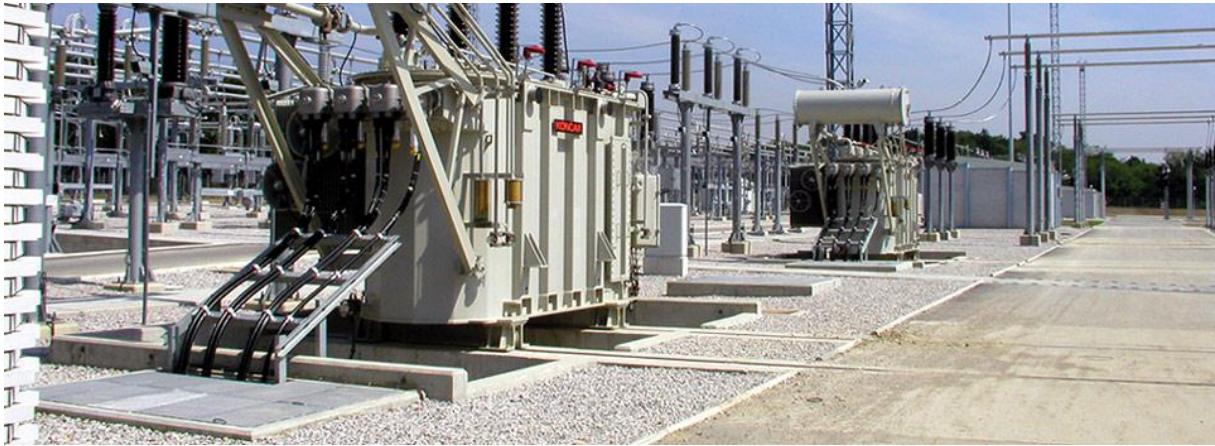
Slika 6.2. Prikaz energetskeg transformatora 110/20kV u TS Žerjavinec
