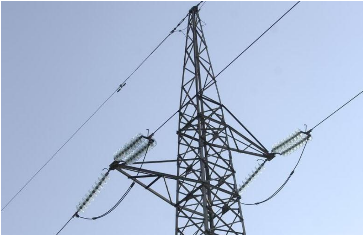
Slika 2.7. Zaštitno uže na vrhu dalekovoda
