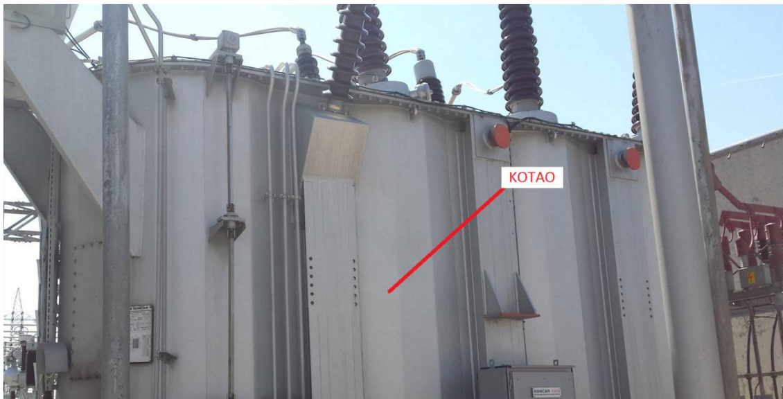
Slika 2.5: Kotao energetskeg transformatora, TS Meline
