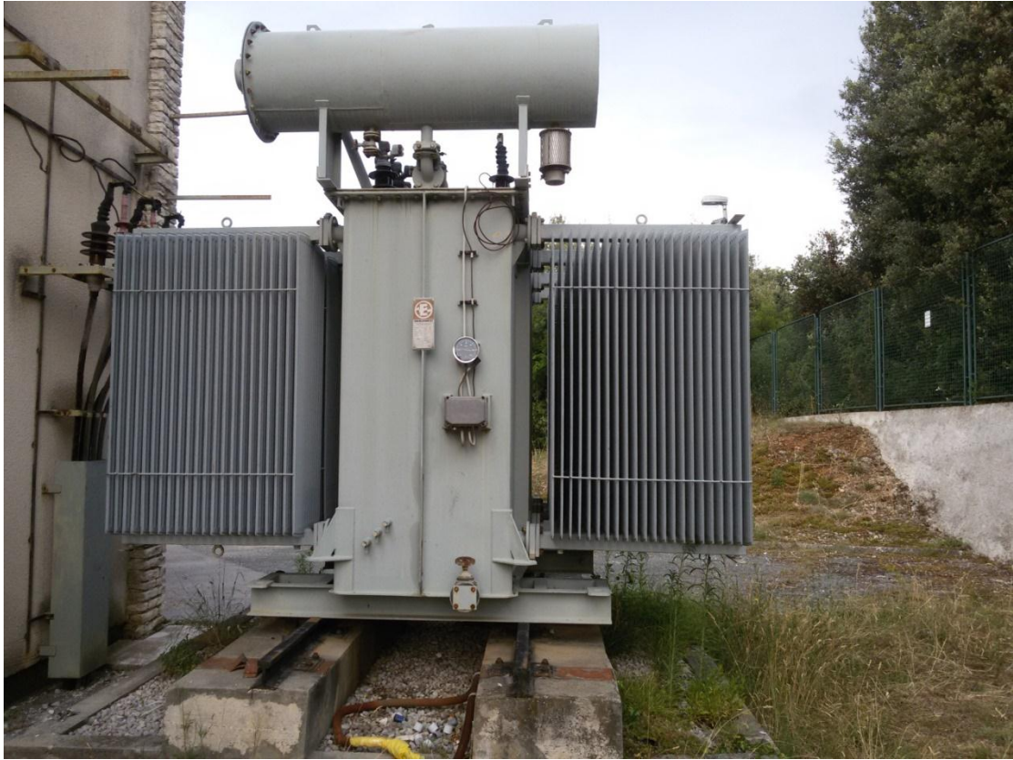
Slika 2.14: Prikaz pasivnog hlađenja energetskeg transformatora
