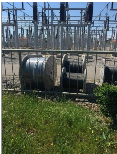
Slika 2.2. Podzemni kabeli upostrojenju kod TS Melina
